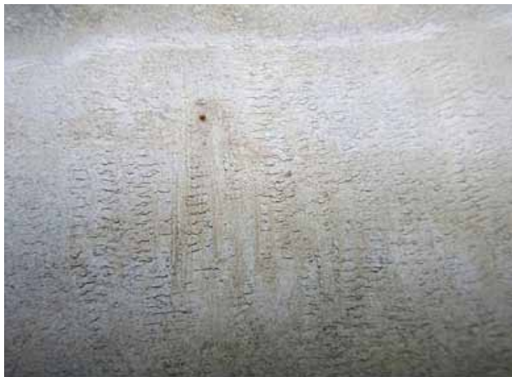
图13 MPI 证实了SCT™检测出的应力腐蚀开裂的微裂缝。
