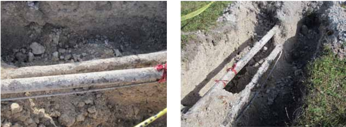
图14&15 SCT™ 的3D制图功能检测到地下地球运动导致一对平行管道的横向变形。
